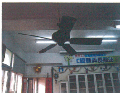
說明：4. 設備更換前(壞掉的)
